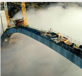
Acabando las pilas del viaducto récord mundial en arco ferroviario. Viaducto de Almonte. AVE Alcántara-Garrovillas. David Carnero. Finishing the piers over the world record arch of a railway bridge. Almonte Viaduct. Alcántara-Garrovillas HSR.
