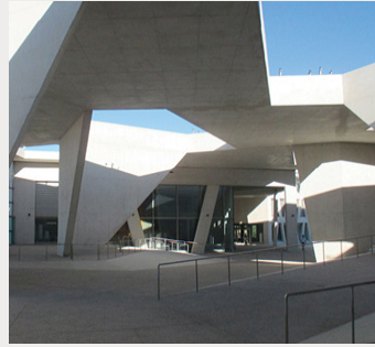
Construcción del nuevo colegio alemán en Madrid. Sergio Santos. New Deutsche Schule construction in Madrid.
